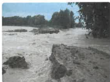
Brèche dans la digue de Aimargues entre Bornier et Teillan lors de la crue de septembre 2002
