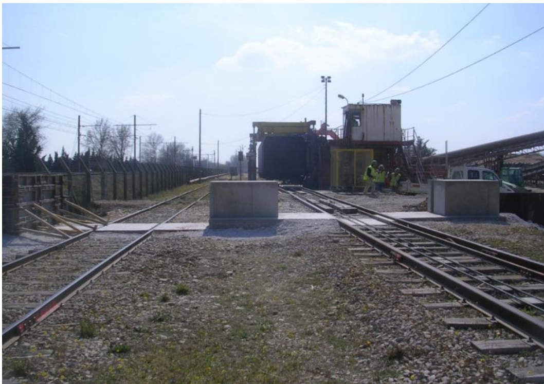
FIGURE 53 : EXEMPLE D'UN BATARDEAU AMOVIBLE MIS EN PLACE SUR DEUX VOIES FERREES A TARASCON (EGIS, 2014)
