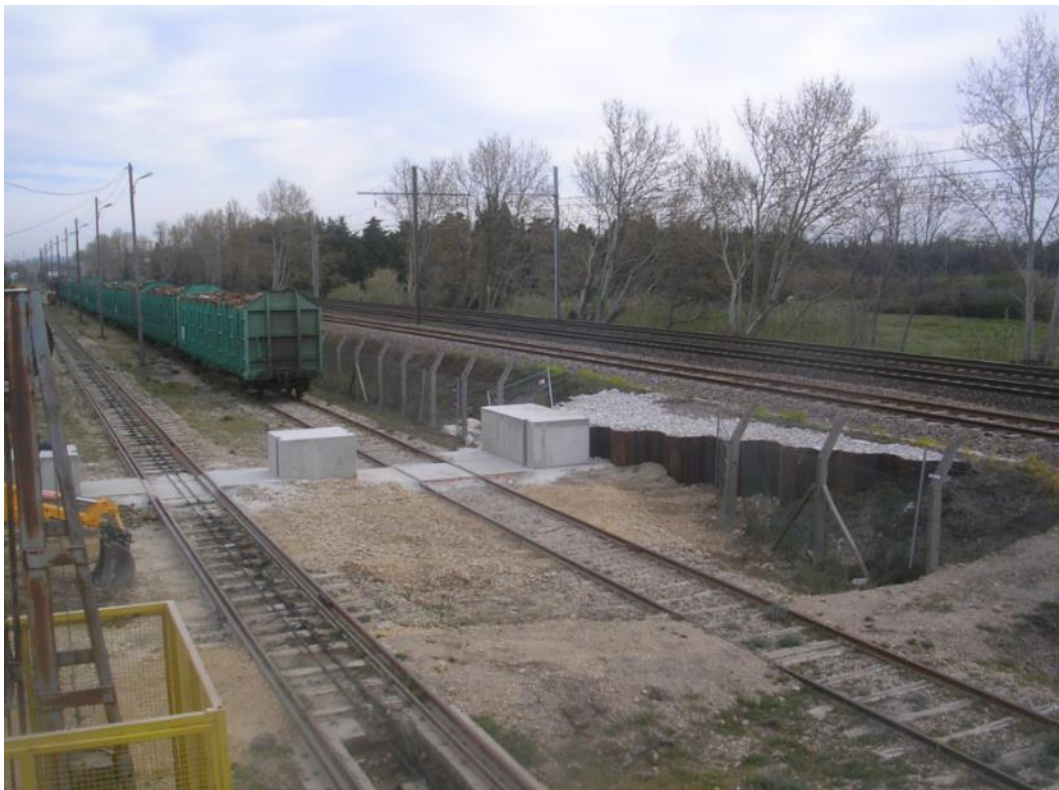
FIGURE 52 : EXEMPLE D'UN BATARDEAU AMOVIBLE MIS EN PLACE SUR DEUX VOIES FERREES A TARASCON (EGIS, 2014)
