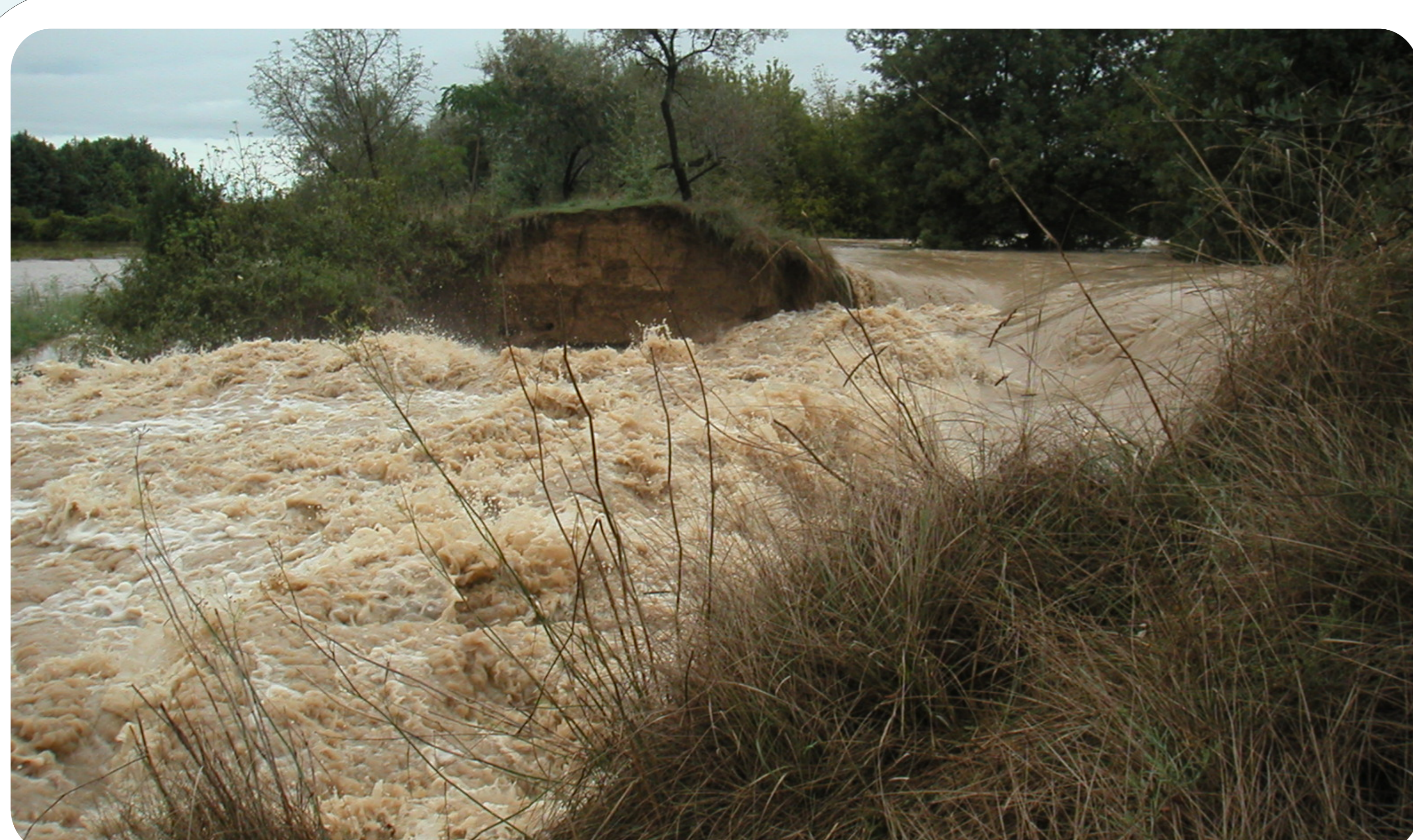
Brèche dans la digue de Marsillargues lors de la crue de septembre 2002
