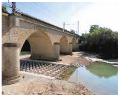
2014, création d'une passe à poissons sous le pont de la voie ferrée Nîmes-Montpellier
