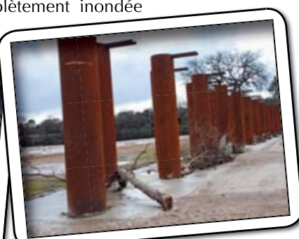
Embâcles retenues par le peigne au lendemain de la crue
